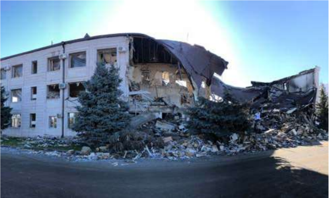
Պատկեր 15.19. «Արցախէներգո»-ի՝ հարձակումից հետո զգալի վնասներ կրած վարչական շենքը Ստեփանակերտում, 4 հոկտեմբերի, 2020թ.: Շենքի կառուցվածքային փլուզումը բնորոշ է մեկ կամ ավելի պայթյուններից վնասված շենքերին (Աղբյուրը՝ փաստահավաք խումբ):
